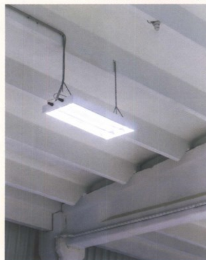
Jedno od novougrađenih rasvjetnih tijela
