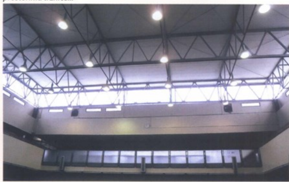
Novougrađena rasvjeta u svim prostorima tržnice...
