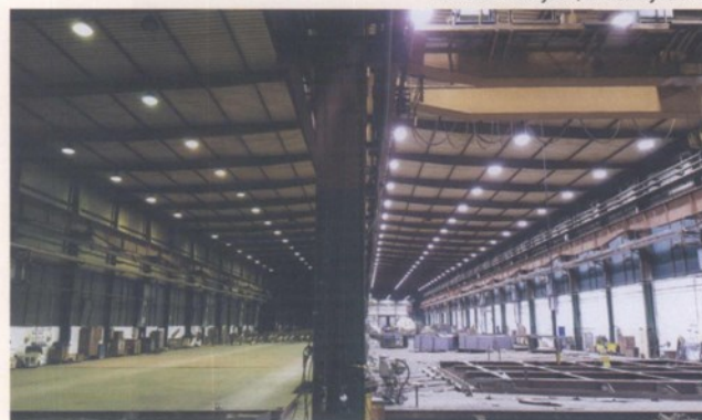
Razlika stare VTW rasvjete (na lijevoj strani) i nove LED rasvjete (na desnoj strani)
